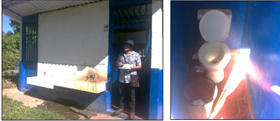
Imagen 3.54: Estado de los servicios sanitarios del centro escolar. Fuente: Grupo de investigación.
