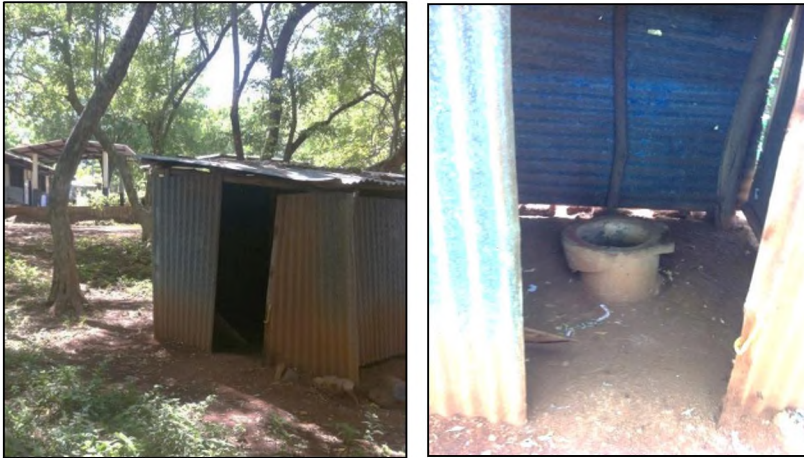
Imagen 3.115: Sanitario de hoyo seco en muy malas condiciones. Fuente: Grupo de investigación.
