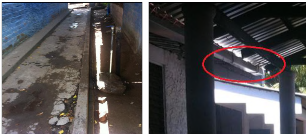
Imagen 3.6: Drenaje pluvial en algunos módulos. Fuente: Grupo de investigación.
