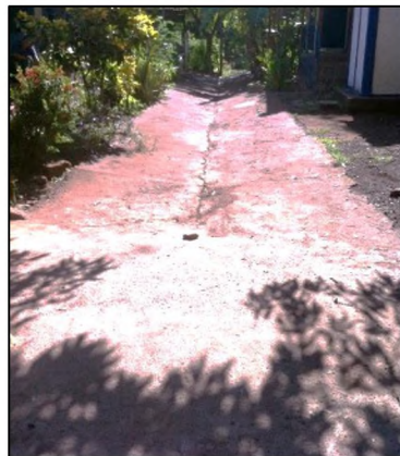
Imagen 3.143: Drenaje pluvial (canaleta hacia la calle) . Fuente: Grupo de investigación.
