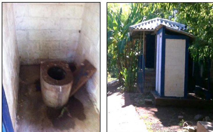
Imagen 3.144: Sistema de hoyo seco . Fuente: Grupo de investigación.
