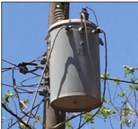
Imagen 3.43: Transformador que abastece al centro educativo, capacidad de 25 KVA. Fuente: Grupo de investigación.
