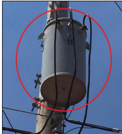
Imagen 3.118: Transformador que abastece al centro educativo, capacidad de 15 KVA. Fuente: Grupo de investigación.
