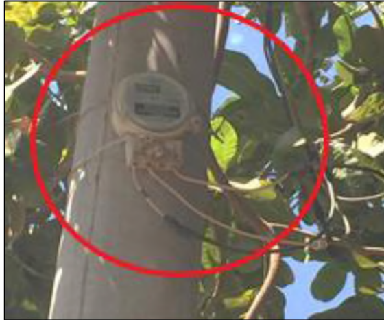
Imagen 3.56: Contador eléctrico del Centro Escolar. Fuente: Grupo de investigación.
