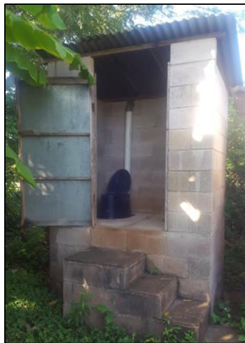
Imagen 3.70: Estado de los servicios sanitarios del centro escolar. Fuente: Grupo de investigación.
