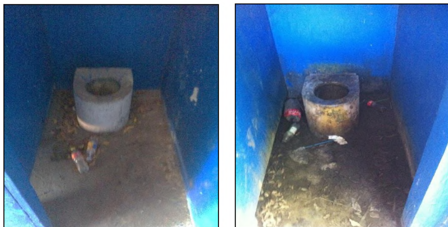
Imagen 3.9: Estado actual de los baños de hoyo seco . Fuente: Grupo de investigación.
