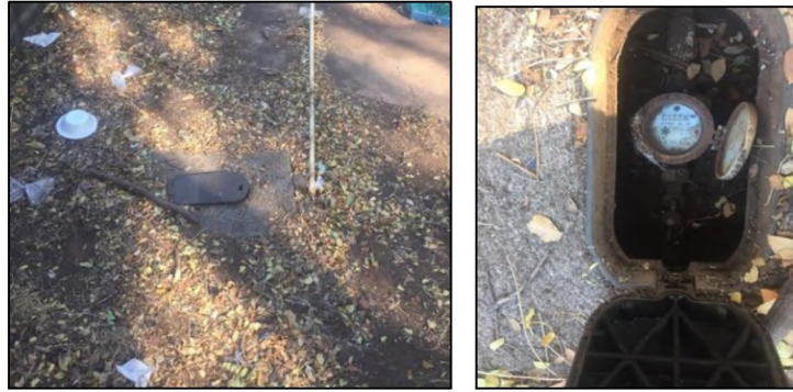
Imagen 3.127: Acometida de agua con su contador. Fuente: Grupo de investigación
