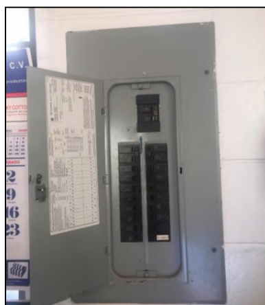
Imagen 3.133: Tablero principal ubicado en la dirección. Fuente: Grupo de investigación.
