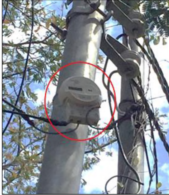
Imagen 3.41: Contador eléctrico del Centro Escolar. Fuente: Grupo de investigación.
