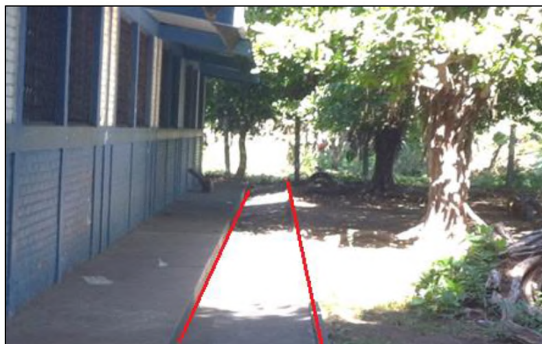
Imagen 3.23: Drenaje pluvial que rodea las estructuras principales del centro escolar. Fuente: Grupo de investigación.
