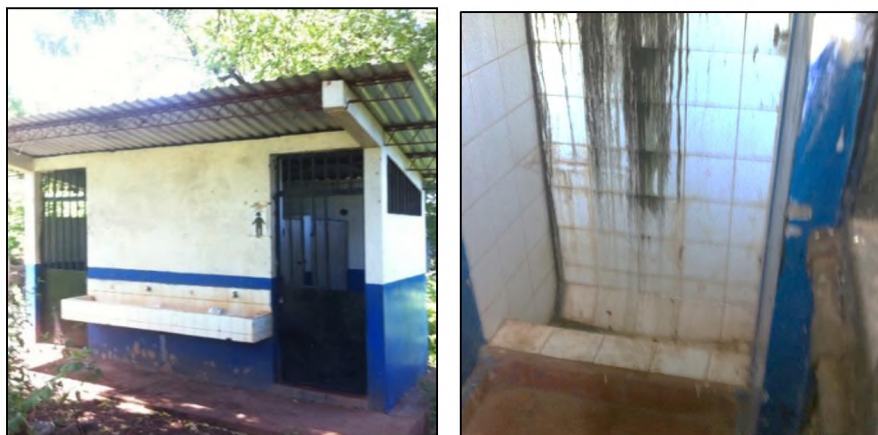
Imagen 3.114: Servicios sanitarios fuera de servicio . Fuente: Grupo de investigación.
