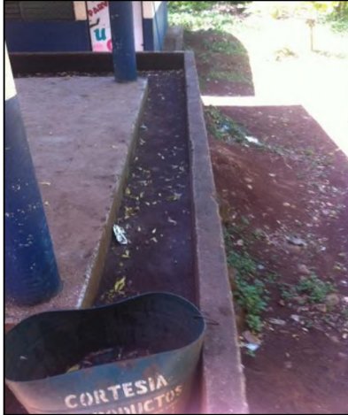
Imagen 3.113: Drenaje pluvial . Fuente: Grupo de investigación.
