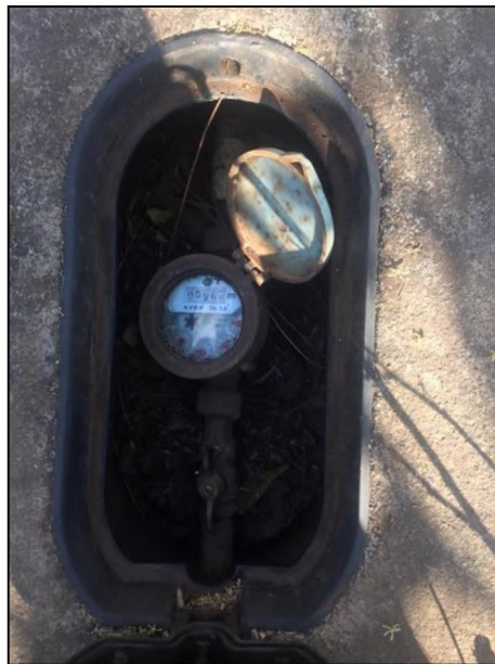
Imagen 3.112: Agua potable proporcionada por ADESCO. Fuente: Grupo de investigación.
