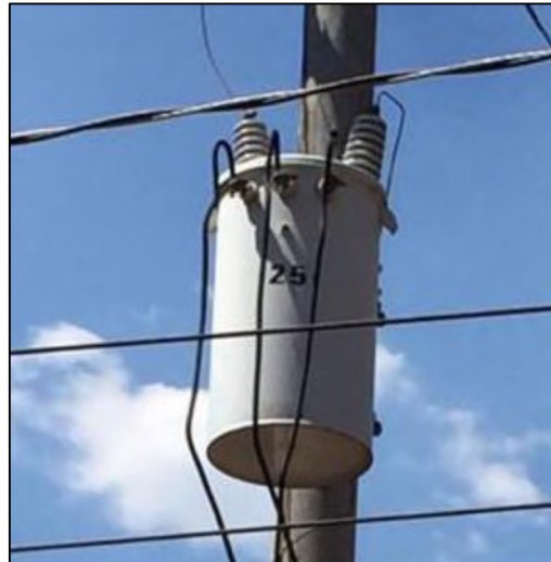
Imagen 3.29: Transformador que abastece al centro educativo, capacidad de 25 KVA. Fuente: Grupo de investigación.
