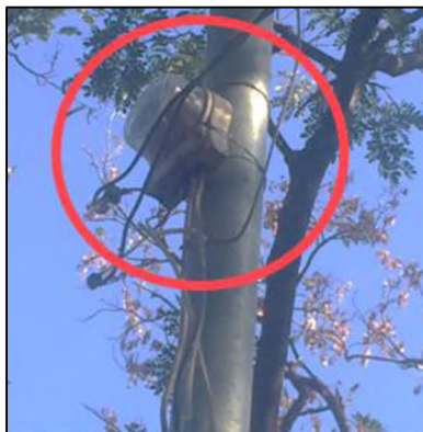
Imagen 3.132: Contador eléctrico del Centro Escolar. Fuente: Grupo de investigación.
