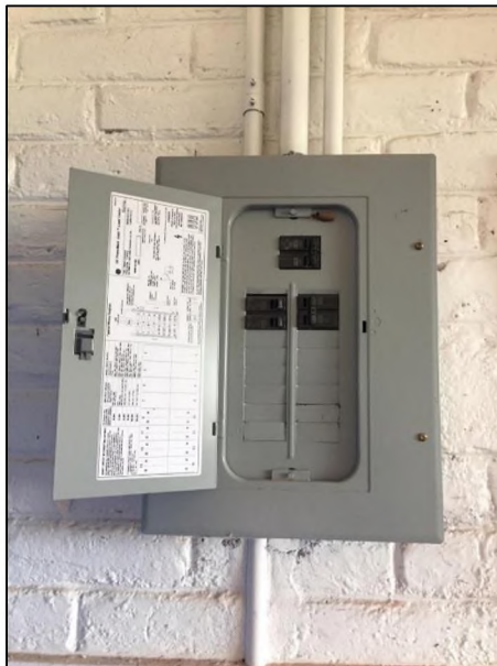
Imagen 3.42: Tablero principal ubicado en la dirección. Fuente: Grupo de investigación.
