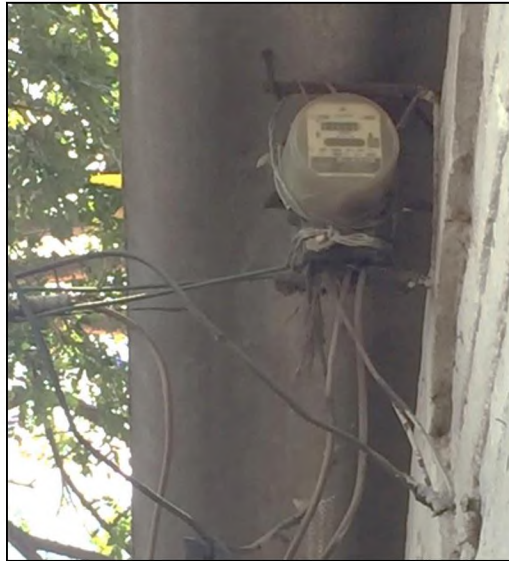
Imagen 3.12: Contador eléctrico del Centro Escolar. Fuente: Grupo de investigación.
