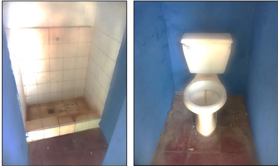
Imagen 3.40: Estado de los servicios sanitarios. Fuente: Grupo de investigación.
