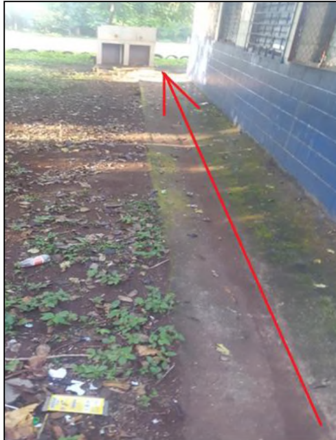
Imagen 3.84: Drenaje pluvial que rodea la estructura principal del centro escolar. Fuente: Grupo de investigación.
