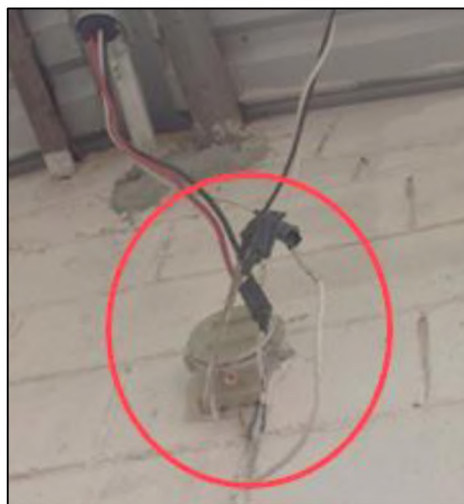
Imagen 3.88: Contador eléctrico del Centro Escolar. Fuente: Grupo de investigación.
