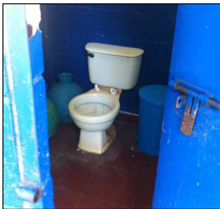
Imagen 3.130: Estado de los inodoros. Fuente: Grupo de investigación.
