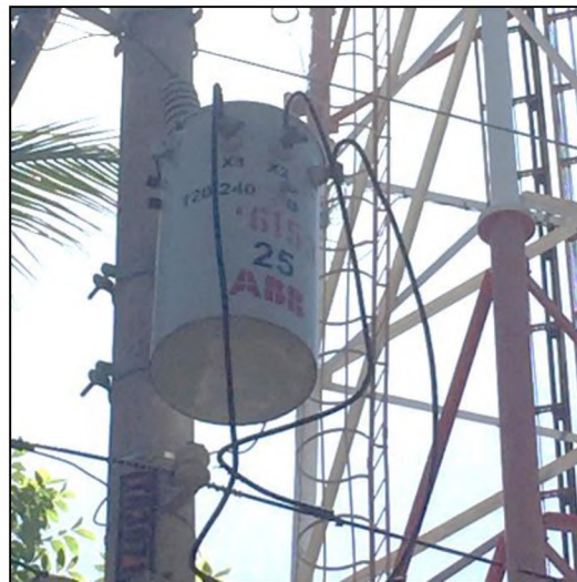
Imagen 3.14: Transformador que abastece al centro educativo, capacidad de 25 KVA. Fuente: Grupo de investigación.
