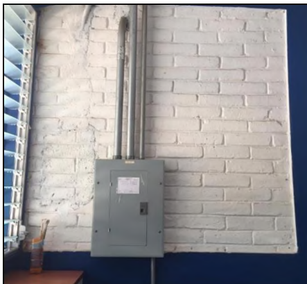
Imagen 3.28: Tablero principal ubicado en la dirección. Fuente: Grupo de investigación.
