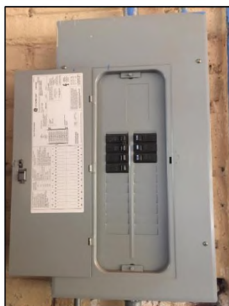
Imagen 3.73: Tablero principal ubicado en una de las aulas. Fuente: Grupo de investigación.
