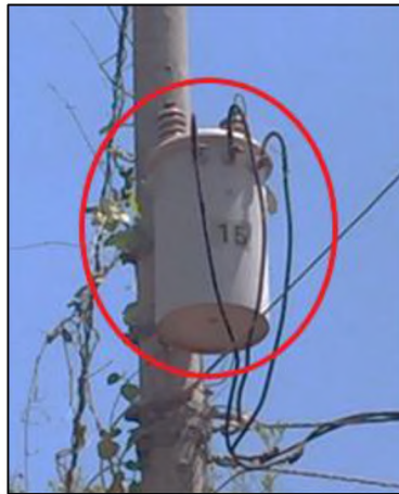
Imagen 3.104: Transformador que abastece al centro educativo, capacidad de 15 KVA. Fuente: Grupo de investigación.
