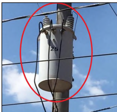
Imagen 3.134: Transformador que abastece al centro educativo, capacidad de 25 KVA. Fuente: Grupo de investigación.
