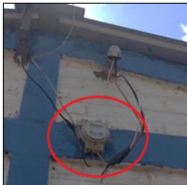
Imagen 3.72: Contador eléctrico del Centro Escolar. Fuente: Grupo de investigación.
