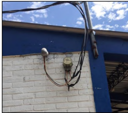
Imagen 3.27: Contador eléctrico del Centro Escolar. Fuente: Grupo de investigación.
