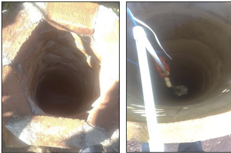
Imagen 3.68: Pozo artesanal fuera de uso y pozo artesanal con equipo de bombeo que abastece la institución. Fuente: Grupo de investigación.
