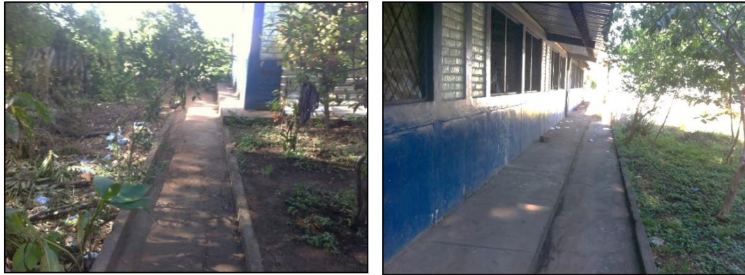
Imagen 3.53: Drenaje pluvial que rodea el pabellón principal del centro escolar. Fuente: Grupo de investigación.
