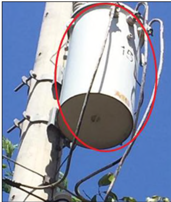
Imagen 3.90: Transformador que abastece al centro educativo, capacidad de 15 KVA. Fuente: Grupo de investigación.
