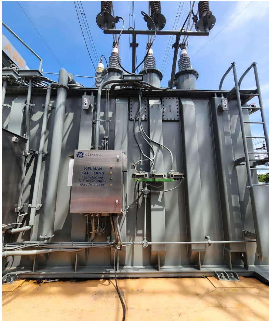
Figura 4.63. Puesta a tierra descargadores de sobretensión
