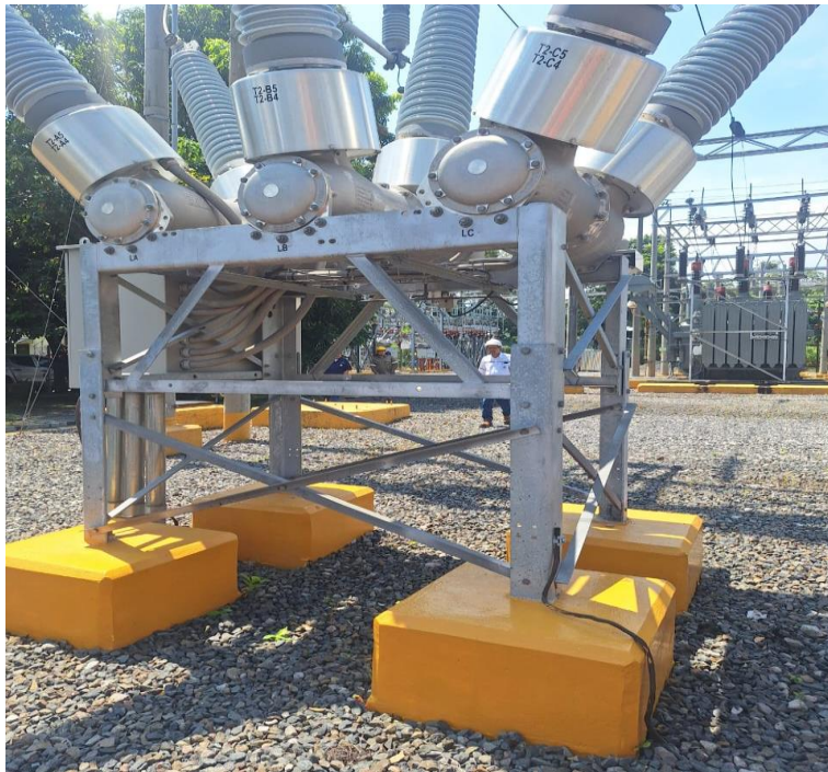
Figura 4.61. Puesta a tierra de interruptores de potencia de 115 kV
