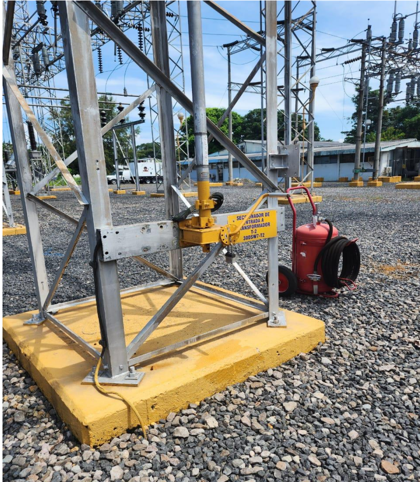
Figura 4.64. Puesta a tierra de seccionador de entrada de 115 kV
