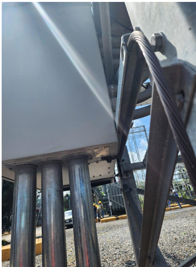
Figura 4.62. Puesta a tierra chasis metálico de tableros
