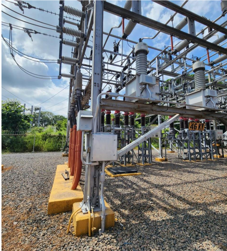
Figura 4.60. Puesta a tierra estructuras de subestación
