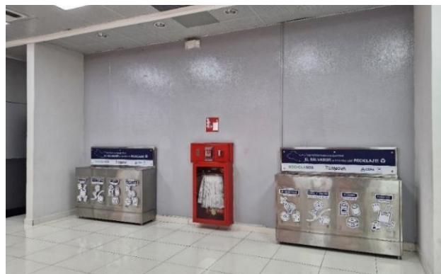
Figura 4. Identificación de Eco- Estaciones de reciclaje.
