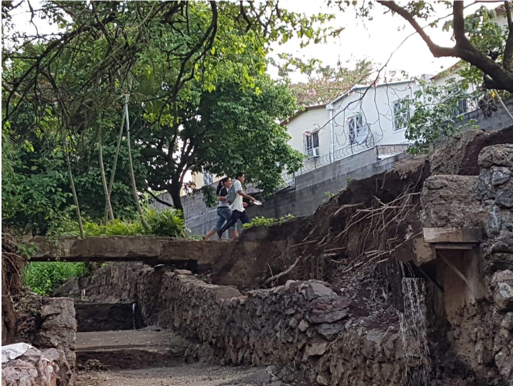
Fotografía 1- 6. Casas aledañas a la quebrada Fuente: Elaboración propia Fecha de captura: 02 de Mayo del 2019
