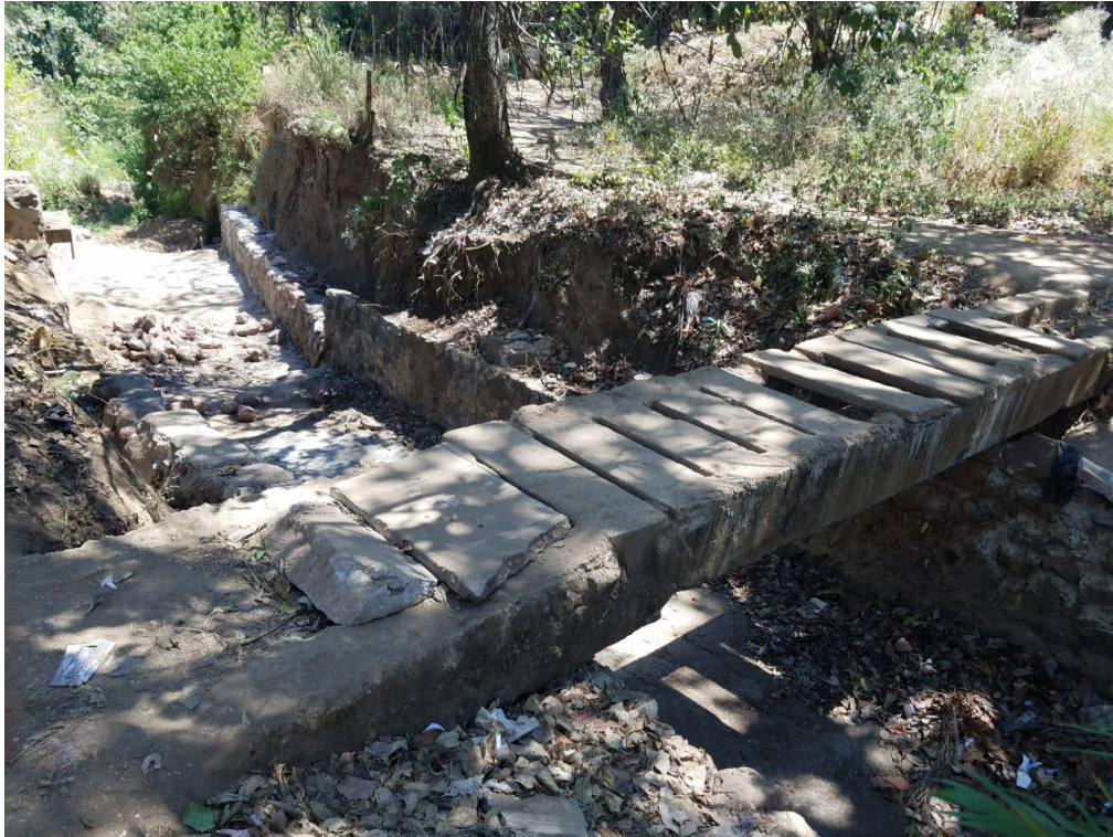
Fotografía 1- 1. Puente provisional Fuente: Elaboración propia Fecha: 16 de Agosto del 2018
