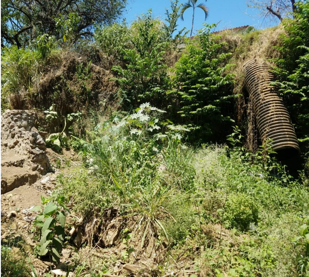
Fotografía 1- 5. Colector de aguas lluvias diámetro 30" PVC
