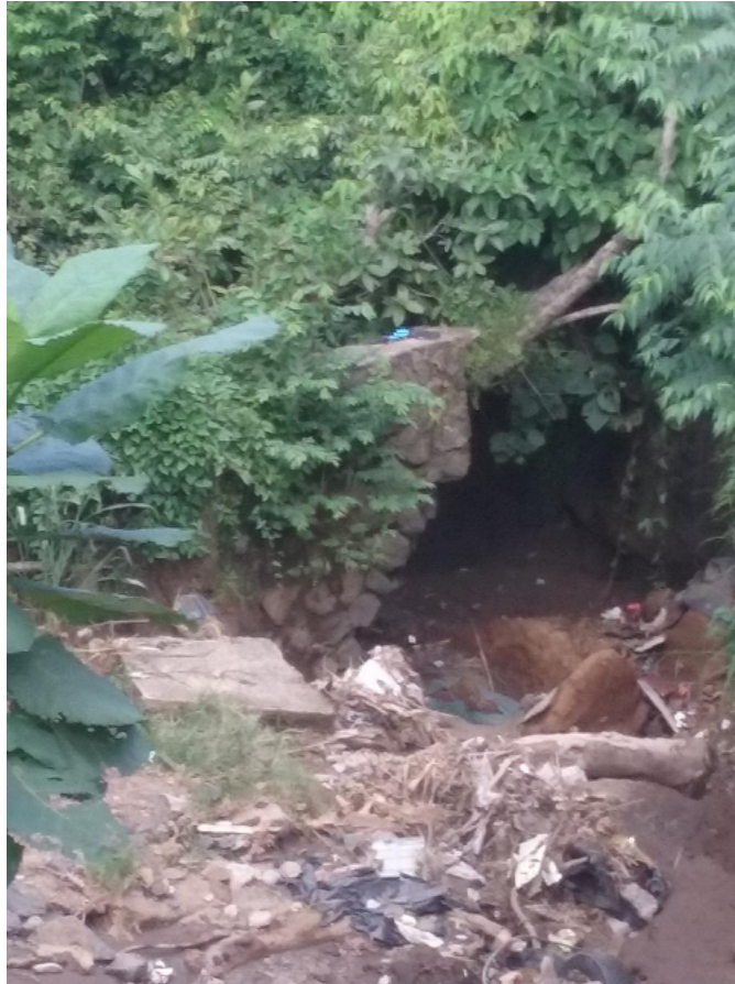
Fotografía 1- 4. Puente peatonal destruido.
