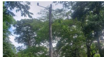
Figura 11. Poste eléctrico en el parque.
