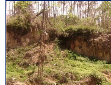
Protección en Parque La Cruz deteriorada
