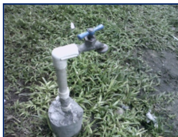
Llave de agua potable
