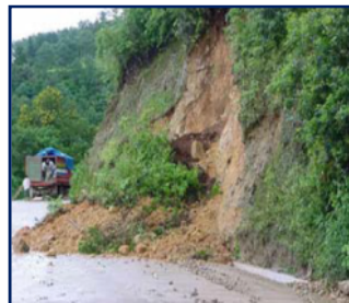
Deslizamiento sobre una carretera
