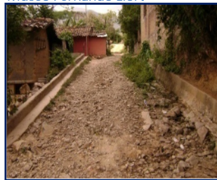
11 Av. Norte. Vía en mal estado
