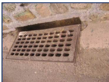
Tragante de aguas lluvias
