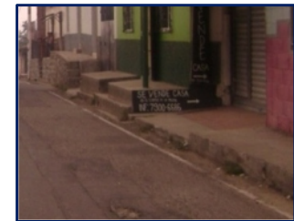
Irregularidad en aceras
