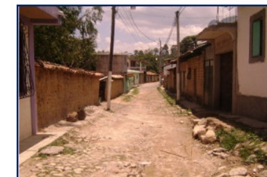
Calle La Cruz, sin recubrimiento y en mal estado
