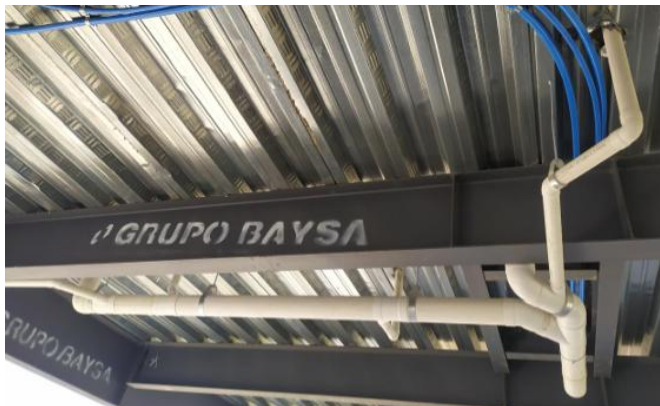
Figura 36 Red Hidráulica en edificio
