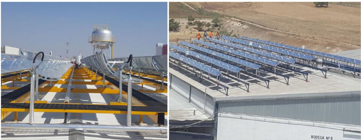
Figura 25 Sistema de concentración solar instalado sobre cubierta de techo (Ref.: Inventive Power ).
