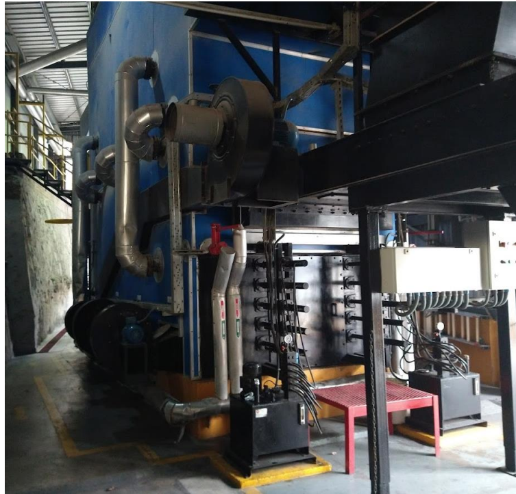
Figura 6 Imagen de caldera de biomasa instalada en LC.
