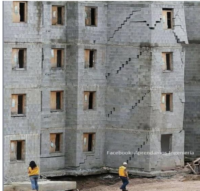
Imagen No. 2-6. Daños en paredes debido al asentamiento diferencial
