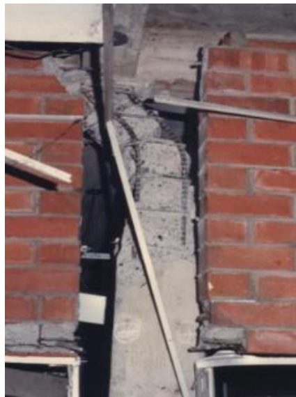
Imagen No. 2-1. Esquema de efecto de viga fuerte – columna débil, obsérvese el colapso de la columna sin daño visible en la viga.
