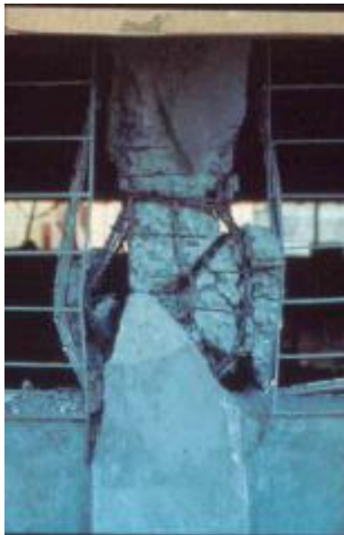
Imagen No. 2-3. Esquema de efecto de columna corta en una edificación, obsérvese la mampostería que arriostra a la columna, sin estar considerado este efecto en el diseño. Foto cortesía Dr. Ing. E. Portillo.
