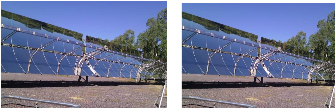
Figura 1.4. Concentrador cilíndrico parabólico construido en LaGeo de Berlín, Usulután, El Salvador.
