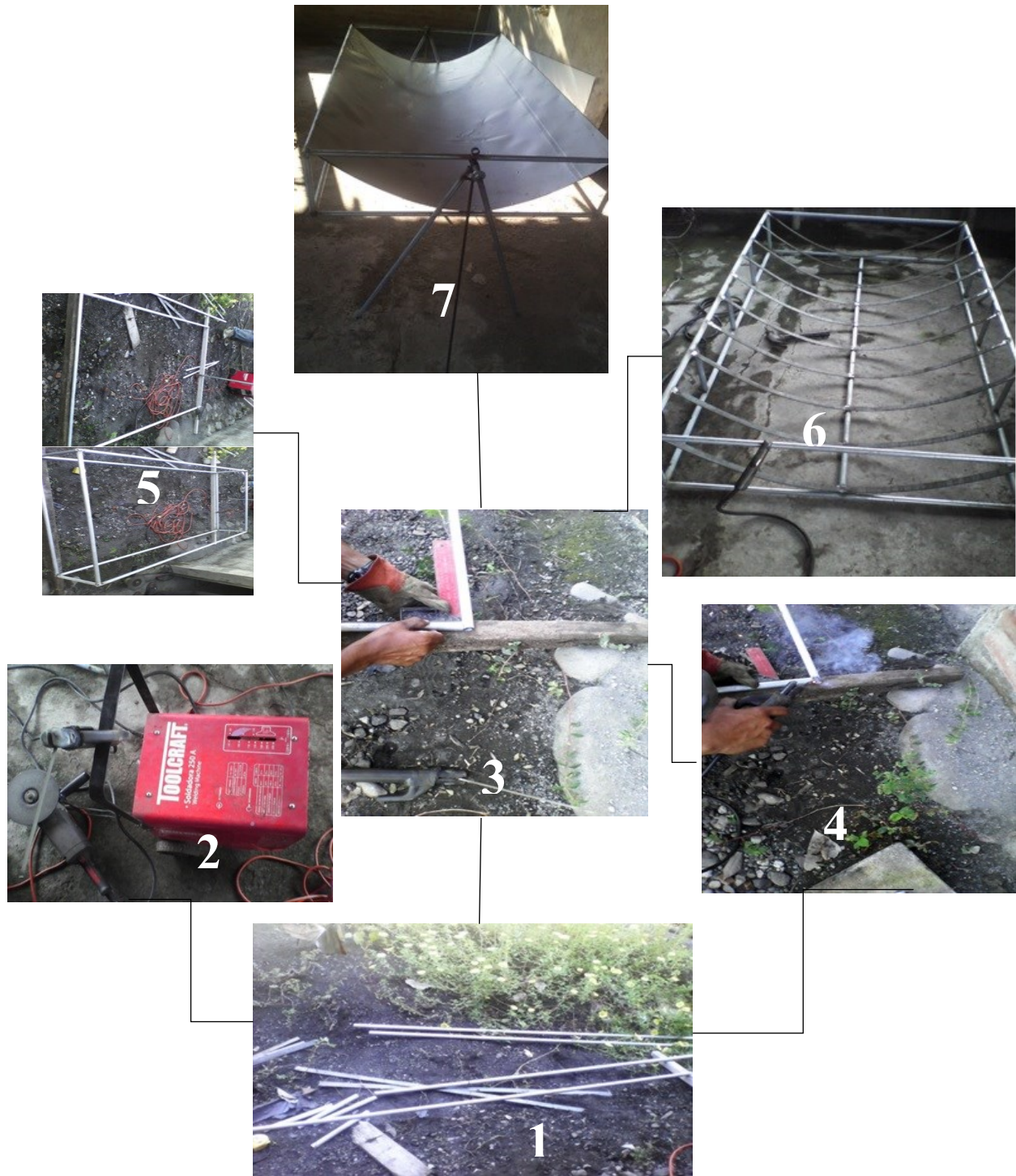
Figura 5.2. Proceso realizado en la construcción del concentrador cilíndrico parabólico. 1. Tubos galvanizados y platina cortados. 2. Equipo industrial para soldar las piezas metálicas. 3. Armando el molde del concentrador. 4. Soldando las piezas metálicas base del concentrador. 5. Armando la estructura del concentrador. 6. Estructura base del concentrador completamente armada. 7. Concentrador cilíndrico parabólico completamente construido.
