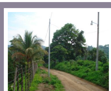
IMAGEN No. 41 Postes de suministro de energía eléctrica y alumbrado público en el Caserío La Mascota.
