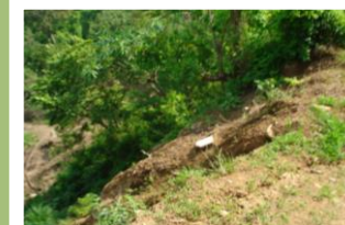
IMAGEN No. 18 Evidente erosión del suelo.
