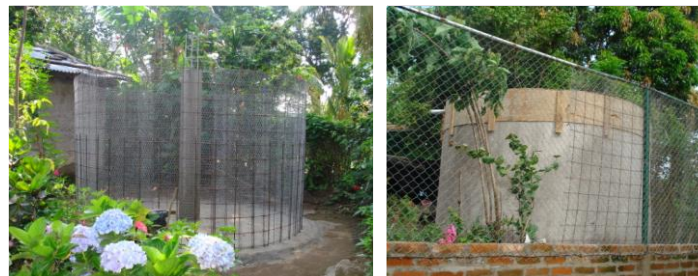
IMAGEN No. 37 Tanque de recolección de agua lluvia en proceso de construcción, en el Caserío La Mascota. Proyecto financiado por ACUA.
