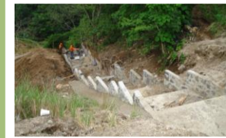
FOTOGRAFÍA No. 2 Caída de agua pluvial hacia el Río San Antonio proveniente de la carretera.
