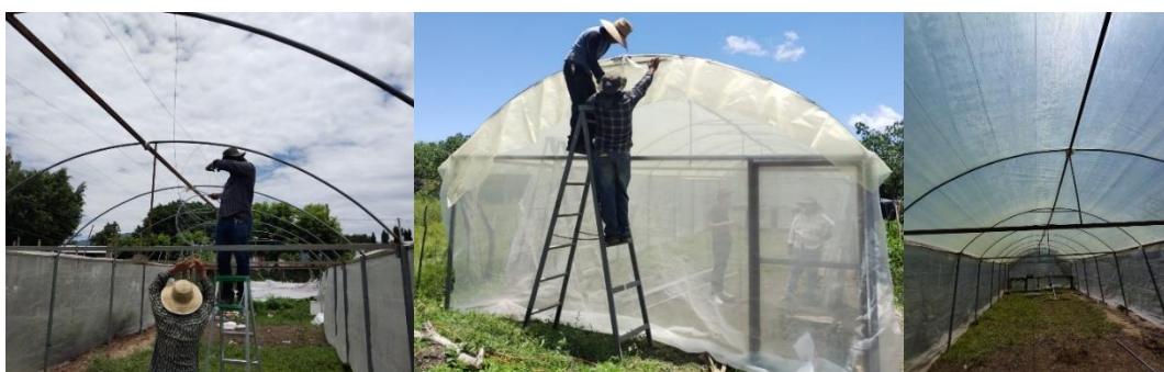
Figura 36. Instalación de película plástica en techo de macro túnel en huerto comunitario de Las Américas 3 y 4 de Nejapa.
