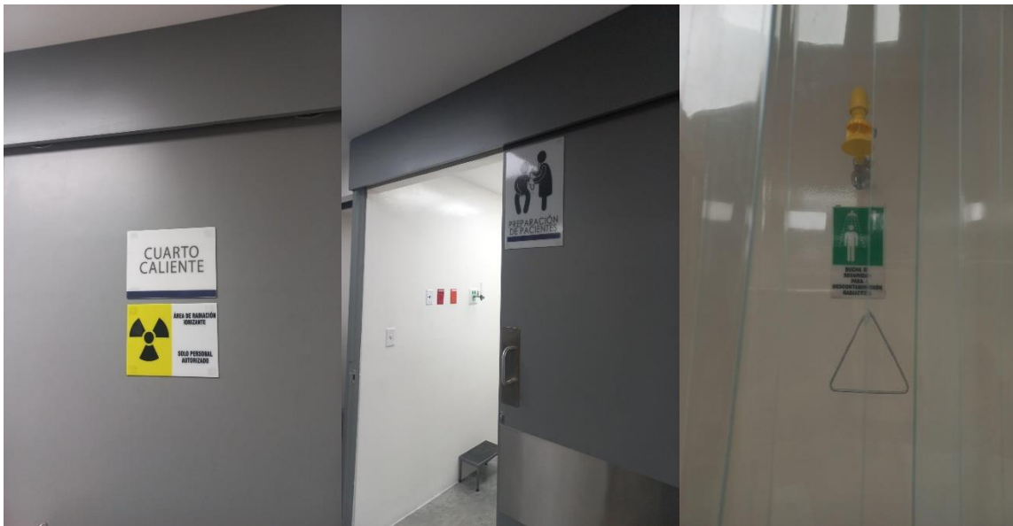
Figura 3. Cuarto Caliente. Figura 4. Cuarto de Preparación de los pacientes. Figura 5. Ducha de Seguridad.
