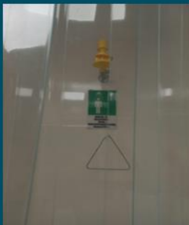
Ducha de seguridad para descontaminación radioactiva.
