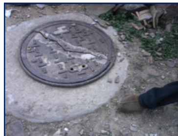
Tapadera de pozo de aguas lluvias
