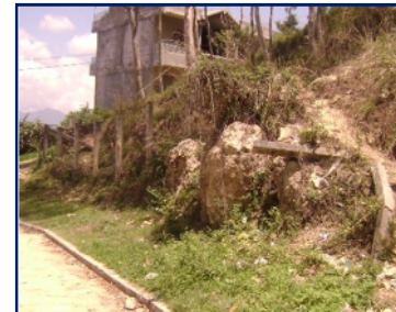
Protección de parque La Cruz en total deterioro
