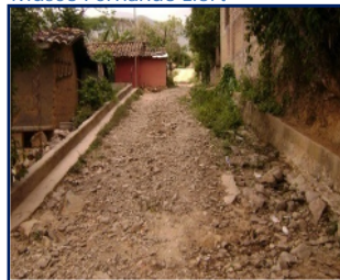
11 Av. Norte. Vía en mal estado
