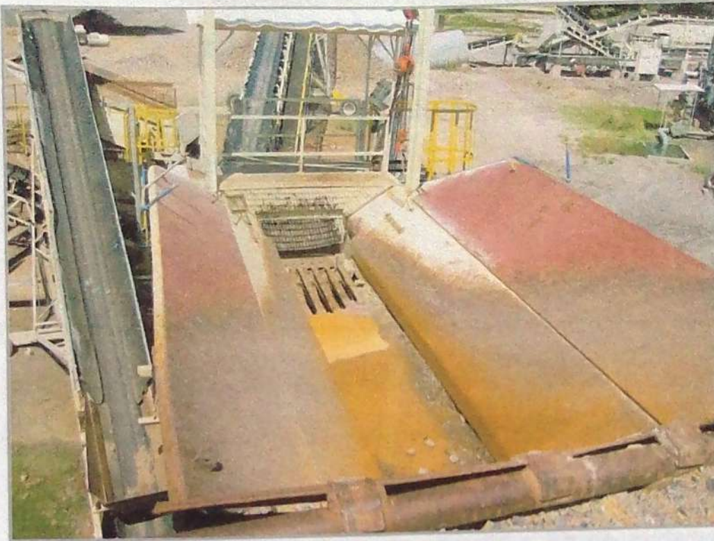
Figura 2.20 Alimentador vibratorio con rejilla de precibado para trituradora de quijadas. Instalación fija de producción de agregados pétreos en Plantel Angue, Municipio de Metapán, Santa Ana.
