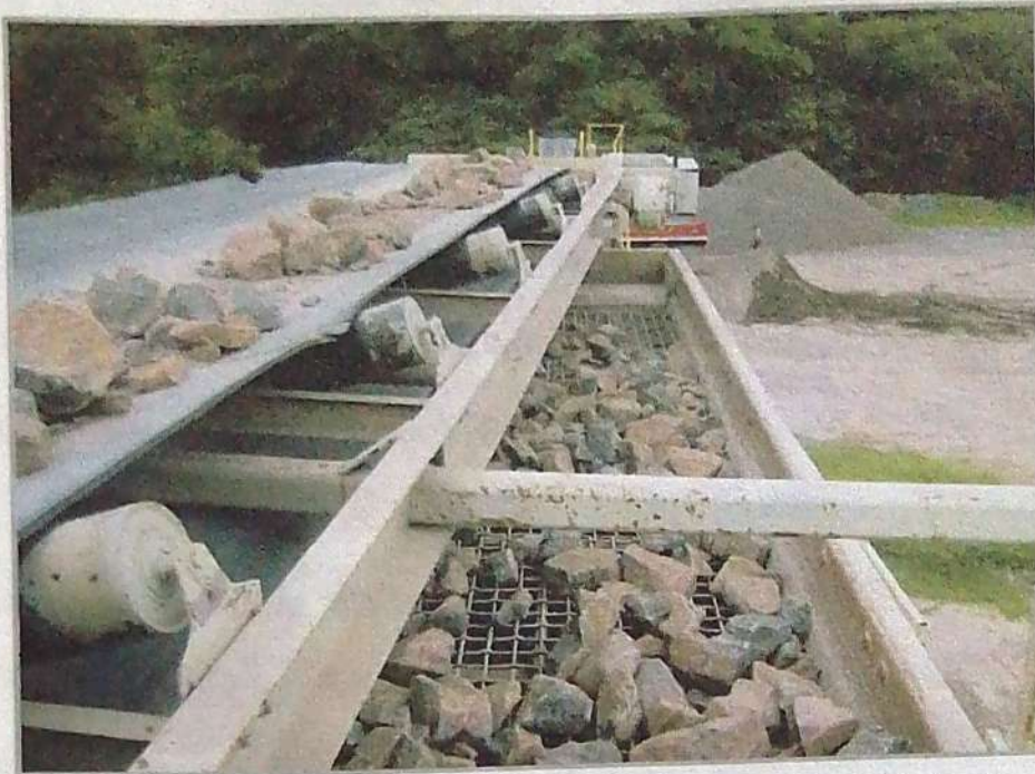
Figura 2.23. Vista superior de una criba vibratoria horizontal alimentada por una banda transportadora. Instalación fija de producción de agregados en Plantel La Bóveda, La Unión.
