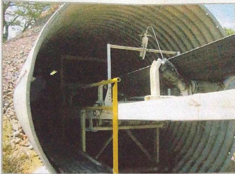
Figura 2.27. Túnel alimentador. El material ingresa por la parte superior a través de alimentadores vibratorios y es transportado por una banda a la siguiente cribadora.
