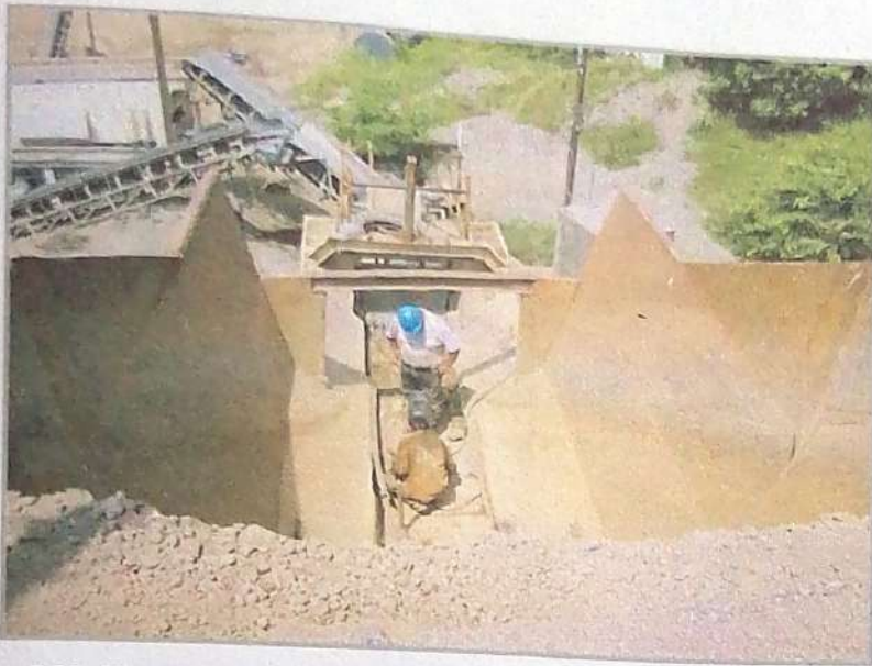
Figura 2.29. Alimentador vibratorio instalado a unos 3 mts. bajo el nivel de descarga.
