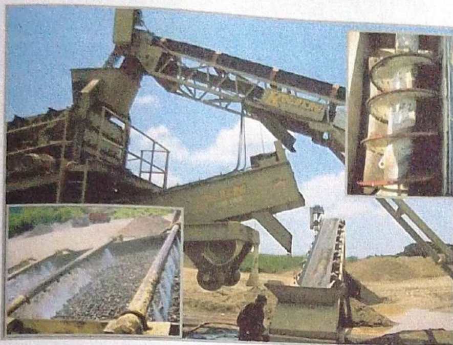
Figura 2.33. Planta portátil de lavado y cribado de agregados. En el extremo derecho superior se observa el tornillo para lavado de arena en el extremo izquierdo inferior el proceso de lavado de grava a través de chorros de agua a presión.
