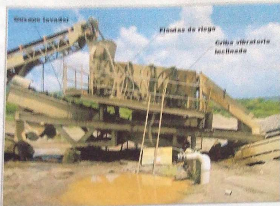
Figura 2.24 Planta portátil de cribado y lavado de agregados pétreos. Plantel Jiboa, La Paz.
