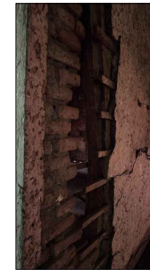
27-ESTADO ACTUAL DE MURO EN N2 IMG_1551.HEIC
