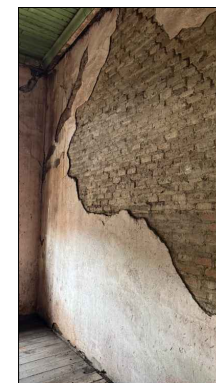
29-ESTADO ACTUAL MURO HABIACIÓN 11 IMG_1557.HEIC
