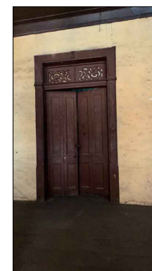
34-ESTADO ACTUAL DE PUERTAS EN N2 IMG_1630.HEIC
