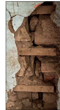
26-DETALLE DE PATOLOGÍA EN MURO IMG_1550.HEIC
