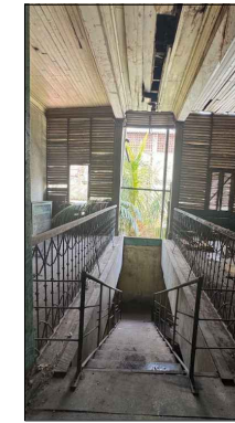
22-ESTADO ACTUAL DE ESCALERA Y PASAMANOS IMG_1540.HEIC
