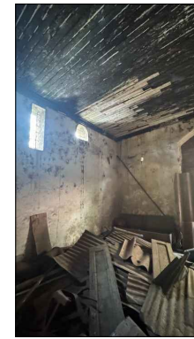
12-ESTADO ACTUAL DE CIELO Y MUROS IMG_1512.HEIC
