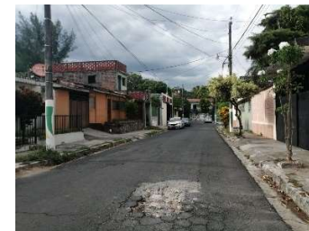
Fotografía 3 - Fotografía de calle principal de colonia Yanira, en mal estado y con poca vegetación, aceras estrechas
