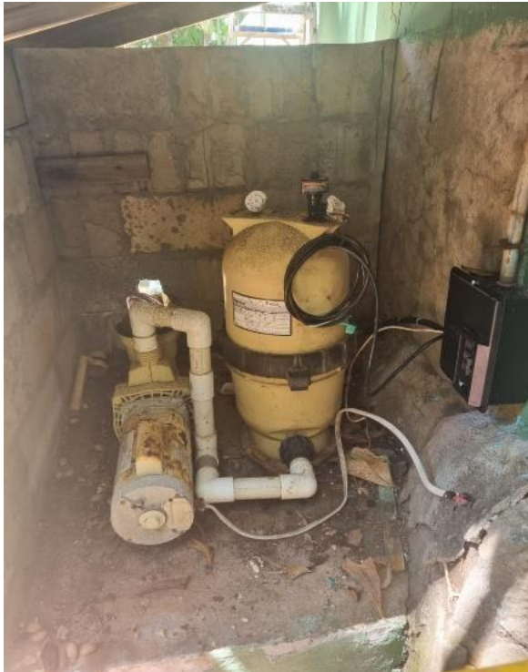
Filtro, bomba y tuberías para cambio.
