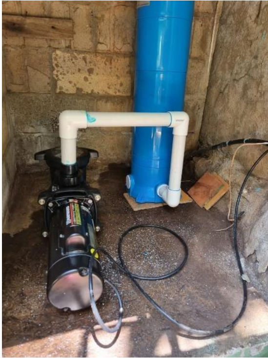
Equipo instalado: bomba, filtro y tubería.
