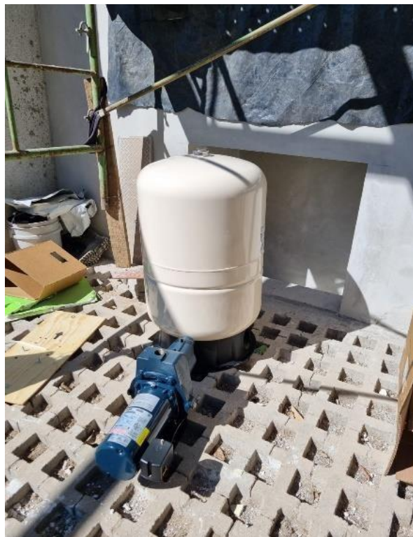
Equipo a instalar.
