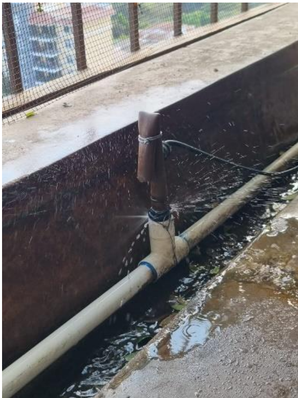
Instalación de microaspersión inadecuada.
