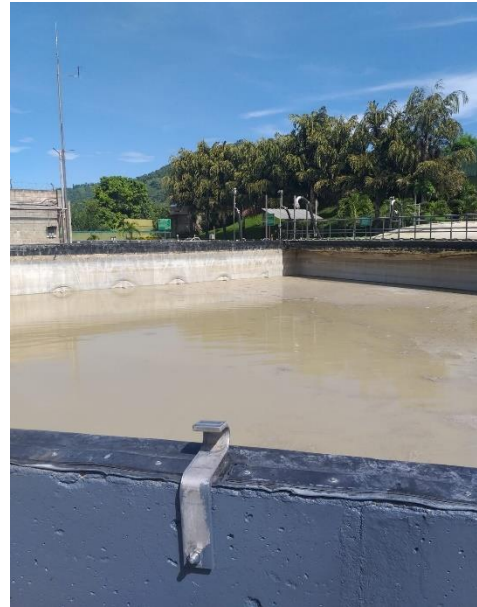
Tanque de agua residual.
