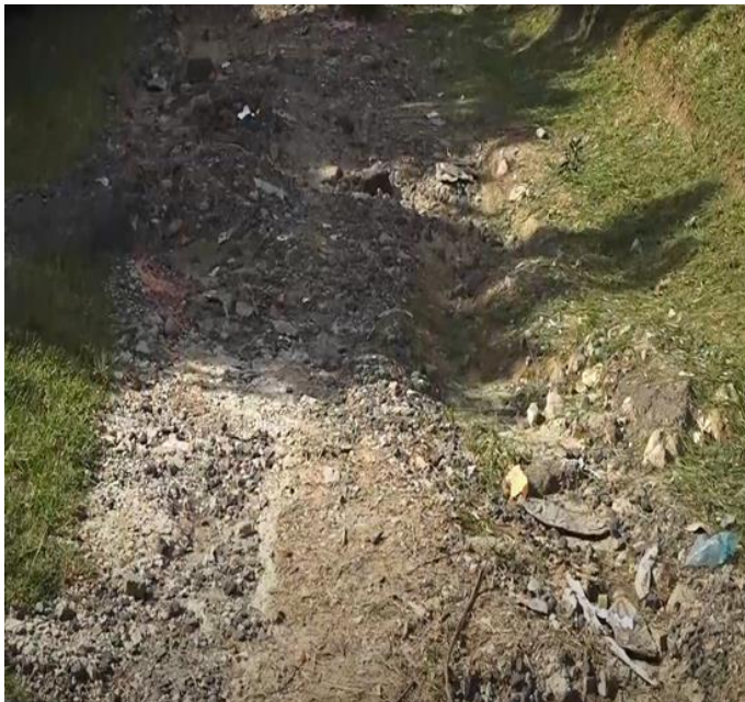
Fotografía No. 17 Vía de tierra en mal estado, con presencia de baches, acumulación de escombros y material erosionado.
