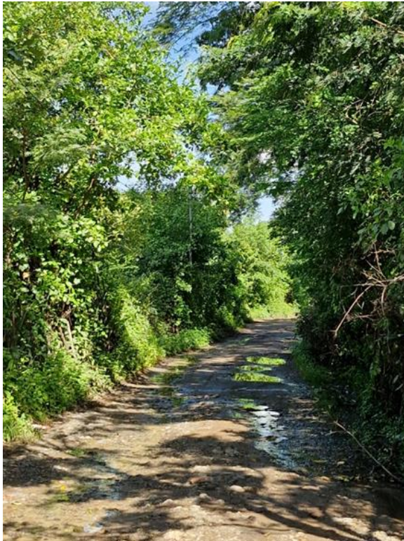
Fotografía No. 5 Presencia de baches a lo largo del sector 1.
