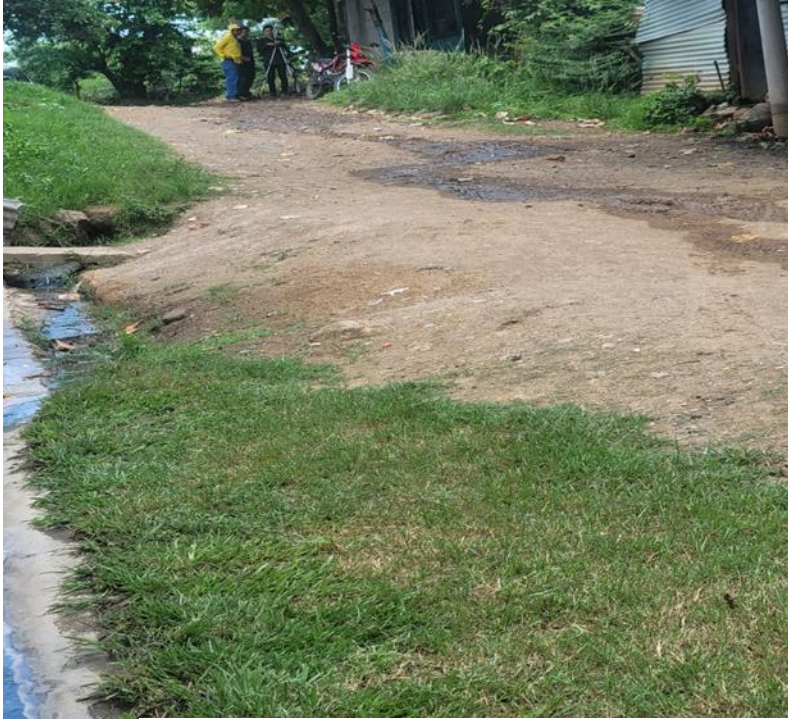
Fotografía 18. El drenaje superficial es deficiente, lo que ha provocado estancamiento de agua y deterioro del terreno.
