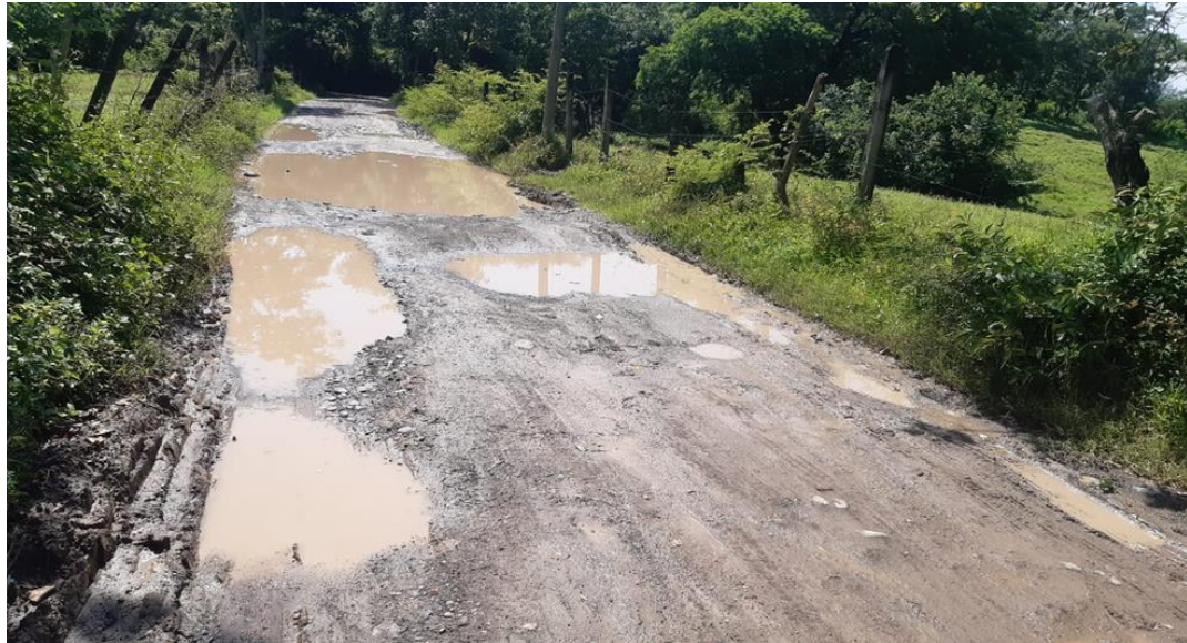
Fotografía No. 13 Sector 2 Tramo 4. Situación del Tramo en la época lluviosa, se forman numerosos baches y depresiones con acumulado de agua lluvia que limita la circulación vial y peatonal.
