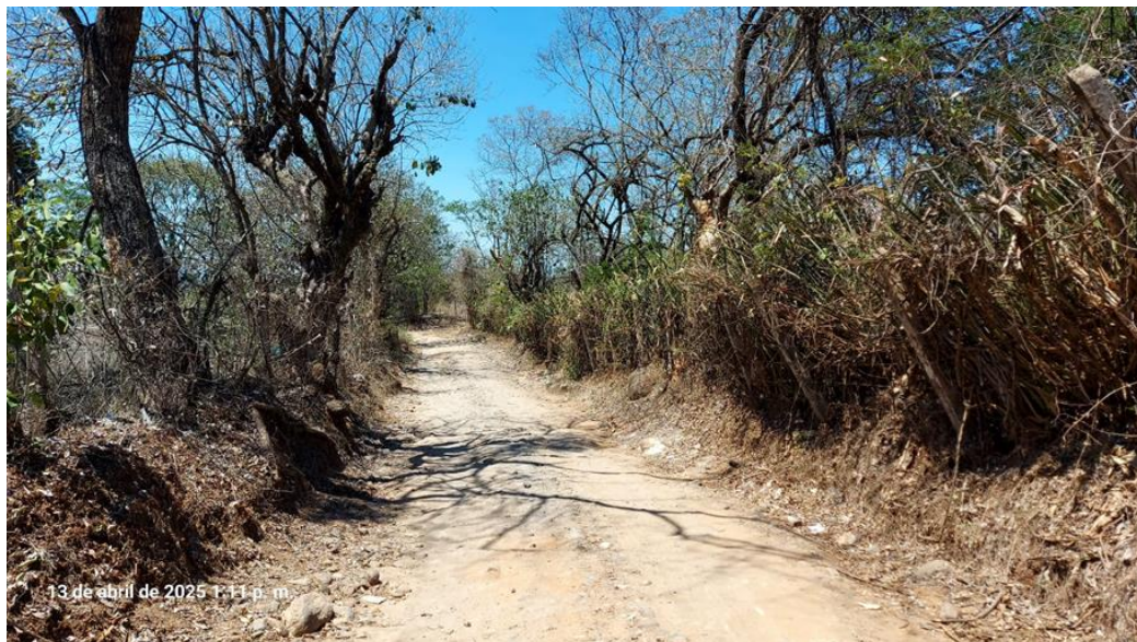
Fotografía No. 10 Sector 2. Tramo 3. Calle con superficie de rodadura de tierra y piedra suelta. Con condiciones irregulares y signos evidentes de erosión superficial y sin drenaje lateral.
