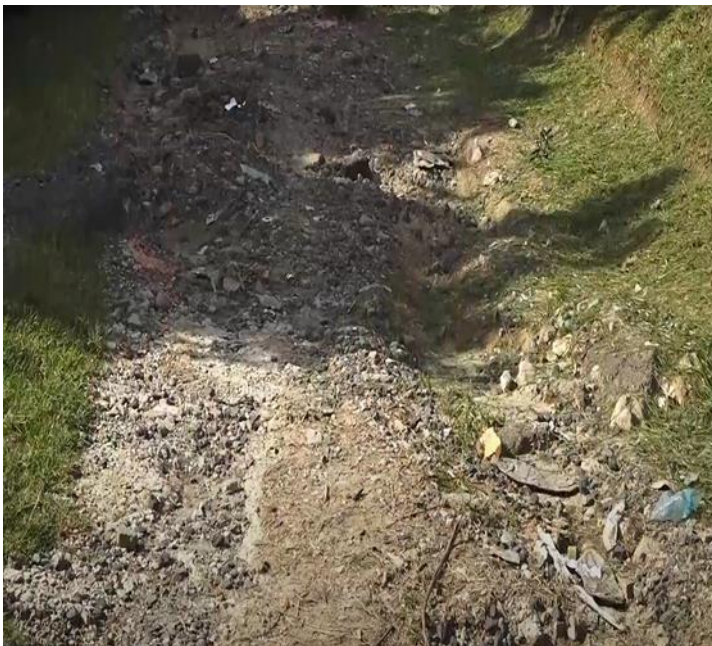
Fotografía 16. Tramo de Vía de tierra con superficie muy deteriorada, presencia de erosión y acumulación de material suelto, lo que dificulta el tránsito vehicular y
