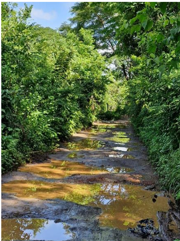
Fotografía No. 6 Acumulación de agua lluvia en los baches.
