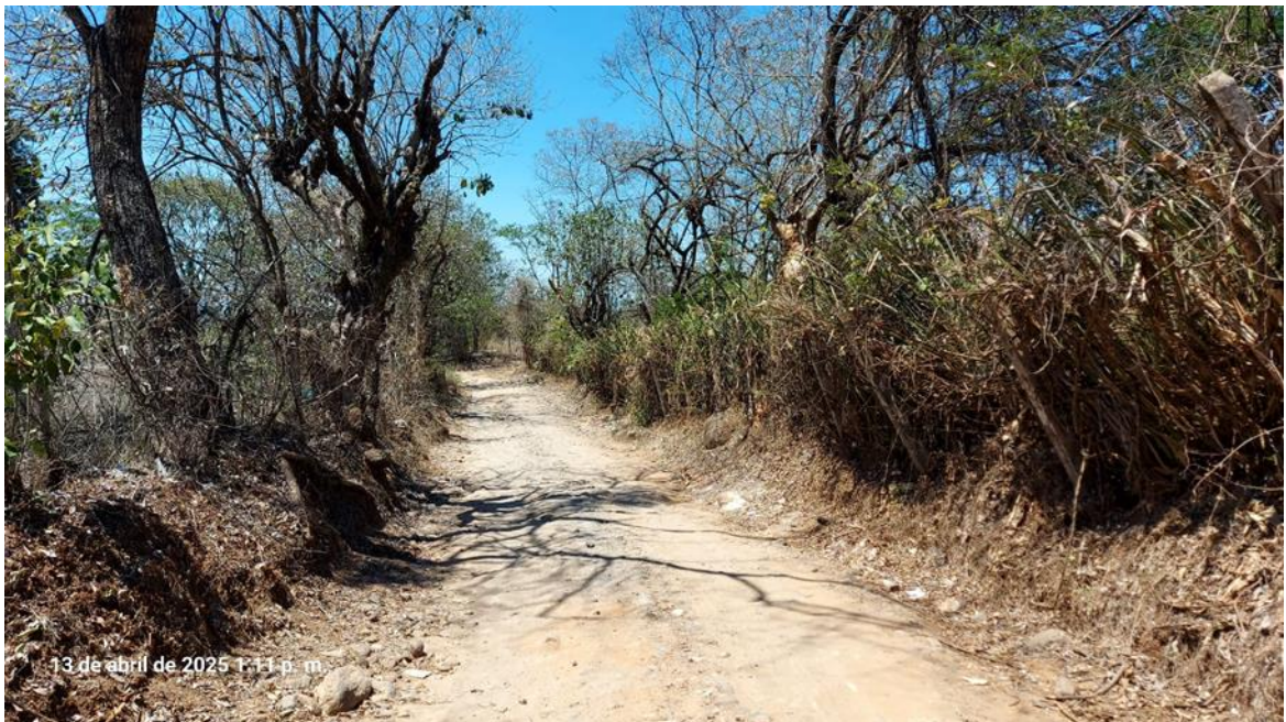
Fotografía 10. Sector 2. Tramo 3. Calle con superficie de rodadura de tierra y piedra suelta. Con condiciones irregulares y signos evidentes de erosión superficial y sin drenaje lateral
