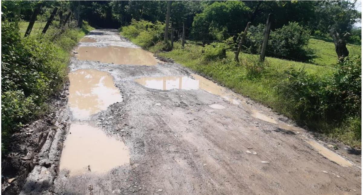
Fotografía 13. Sector 2 Tramo 4. Situación del Tramo en la época lluviosa, se forman numerosos baches y depresiones con acumulado de agua lluvia que limita la circulación vial y peatonal
