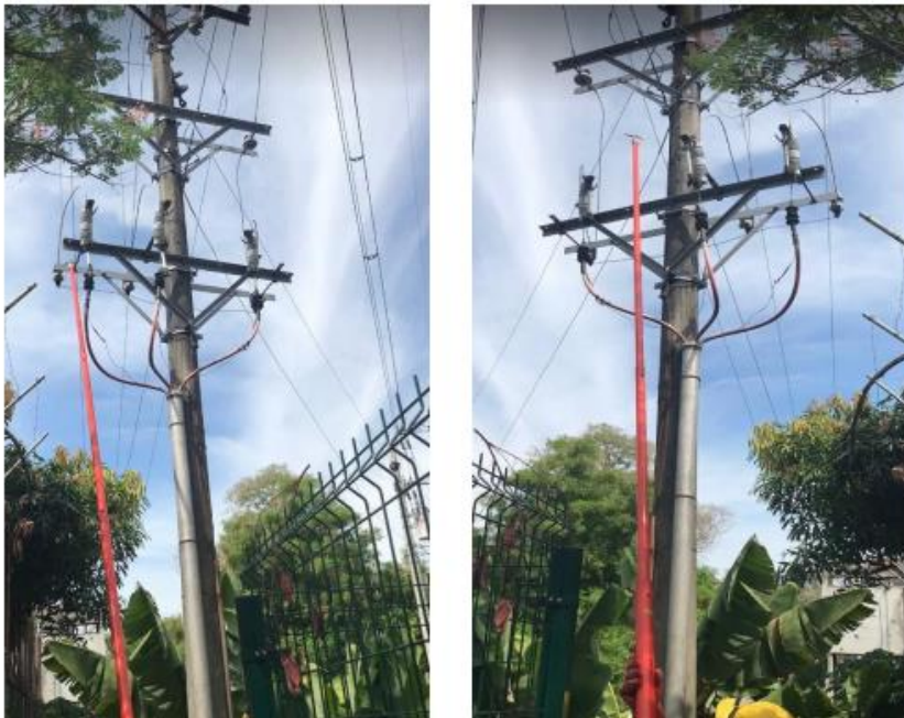
Figura 16: Corte de fusible utilizando Bara universal.
