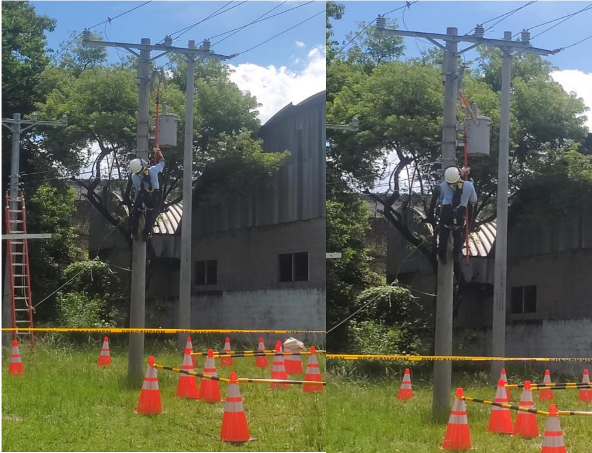
Figura 15: Corte de fusible en media tensión con Load Buster.
