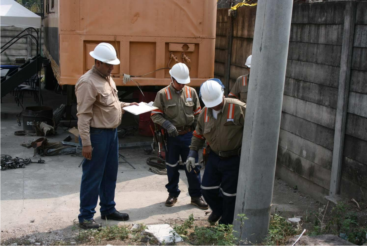
Figura 8: Verificación e inspección de posibles riesgos.
