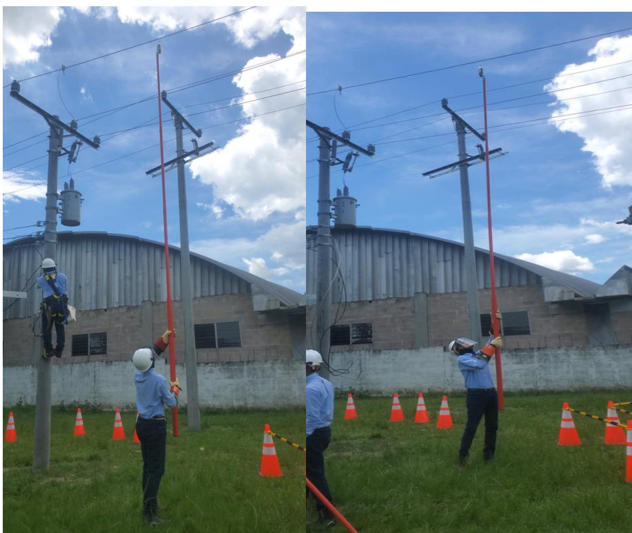
Figura 20: Verificación de ausencia de tensión.
