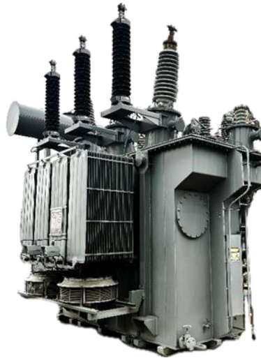
Figura 2. Transformador de potencia utilizado sistemas eléctricos de alta tensión. 115/46kV.
