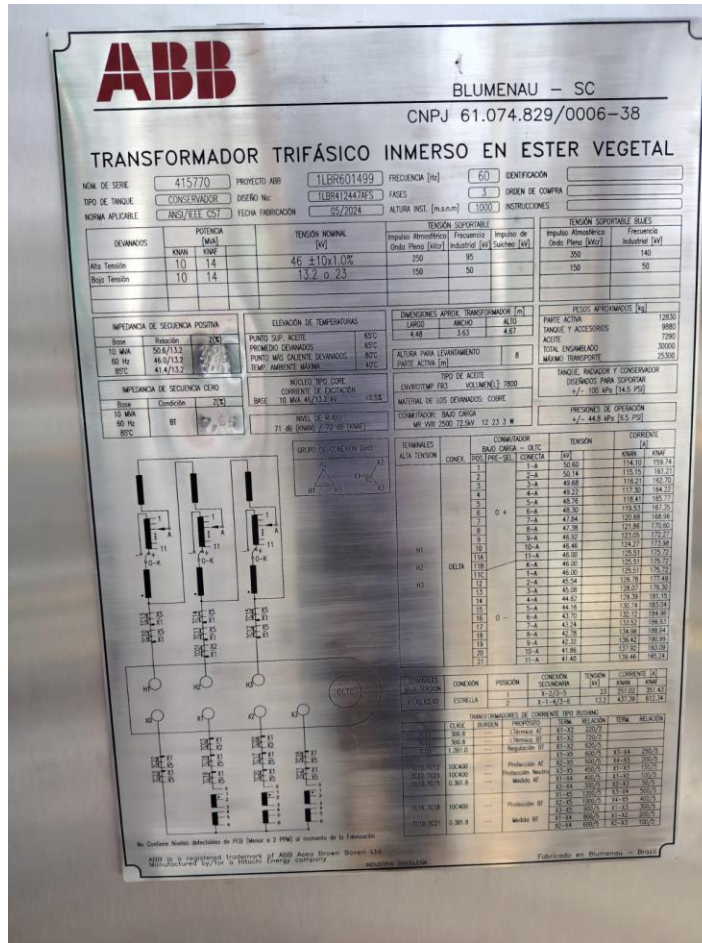
Figura 22. Placa de características del transformador trifásico ABB inmerso en éster vegetal.
