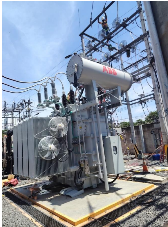
Figura 21. Transformador de potencia ABB instalado en campo, durante labores de conexonado.
