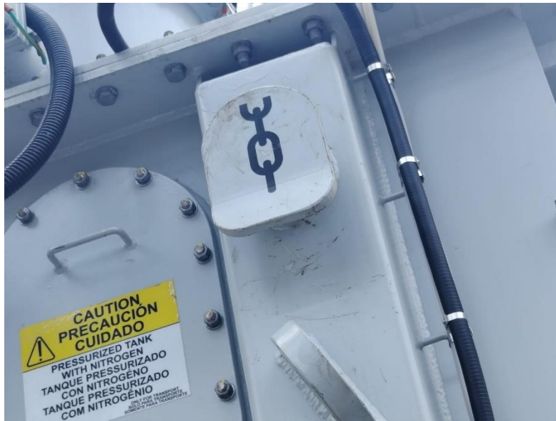
Figura 26. Punto de izaje superior del tanque del transformador ABB, identificado con el símbolo de cadena. Se observa el rótulo de presurización con nitrógeno y leves marcas de desgaste en la superficie metálica.
