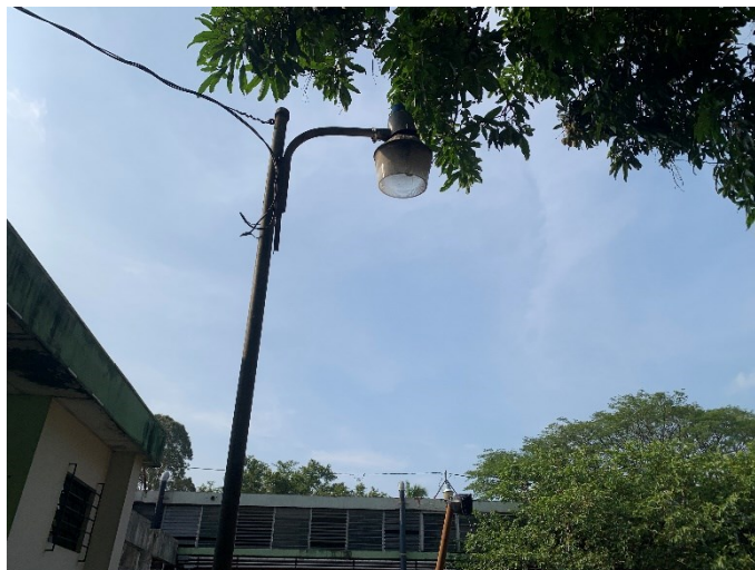
Figura 255 Luminaria tipo farola exterior con bombillo
