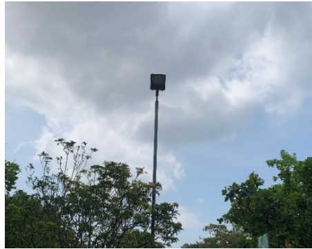
Figura 121 Luminaria tipo reflector kale Street light Doble
