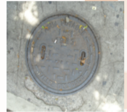
Foto N° 2.32: Pozo Registro de Agua Potable Fuente: Elaboración Propia
