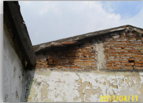
Foto N° 2.88: Vestigios de la estructura de madera del techo. Fuente: Sonia González.
