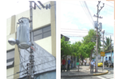
Foto N° 2.36: Poste de tendido Eléctrico, Luminaria y Transformador Fuente: Elaboración Propia
