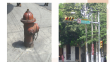
Foto N° 2.44: Hidrante y Semáforo. Fuente: Elaboración Propia
