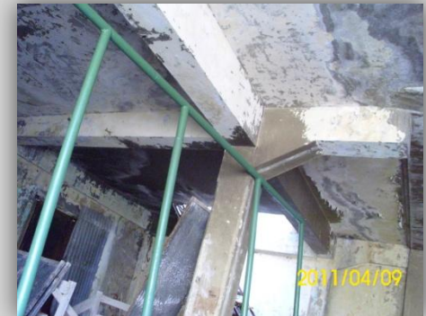
Foto N° 2.90: Los elementos estructurales de la casa están contruidos con concreto. Fuente: Sonia González.
