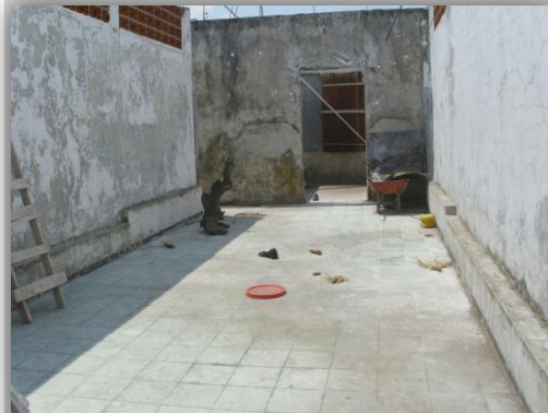
Foto N° 2.108: Detalle de Baldosas decoloradas y manchadas por el sol y la humedad. Fuente: Sonia González.
