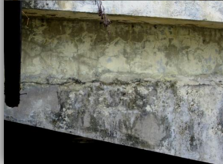
Foto N° 2.118: Detalle de fisura en vigas, segundo nivel. Fuente: Sonia González.
