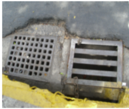
Foto N° 2.31: Resumidero de Aguas Lluvias Fuente: Elaboración Propia
