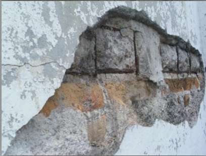
Foto N° 2.106: Detalle de Desquebrajamiento y faltante del Repello. Fuente: Sonia González.
