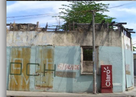
Foto N° 2.8: Manzana S-6. Casa en completó abandono. Fuente: Sonia González.
