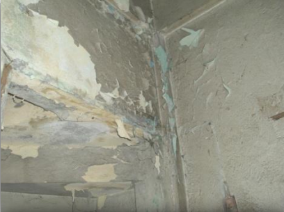
Foto N° 2.105: Detalle de Desprendimiento de Pintura. Fuente: Sonia González.
