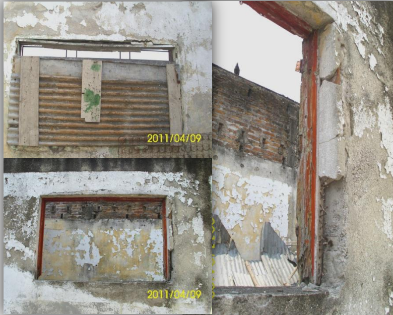
Foto N° 2.113: Detalle de ventanas y sus daños. Fuente: Sonia González.
