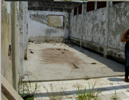
Foto N° 2.110: Detalle de desprendimiento del repello y mancha causada por las aguas lluvias. Fuente: Sonia González.
