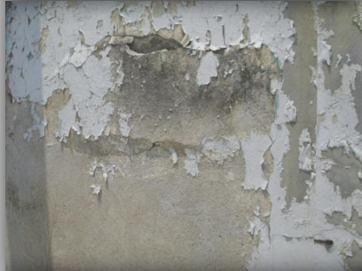
Foto N° 2.107: Detalle de Burbujas y Grietas por falla cortante y de aplastamiento en las Paredes. Fuente: Sonia González.
