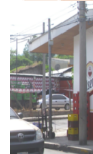
Foto N° 2.37: Poste de Red Telefónica Fuente: Elaboración Propia
