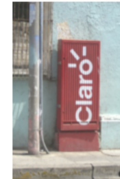
Foto N° 2.35: Caja de Registro Telefónica Fuente: Elaboración Propia
