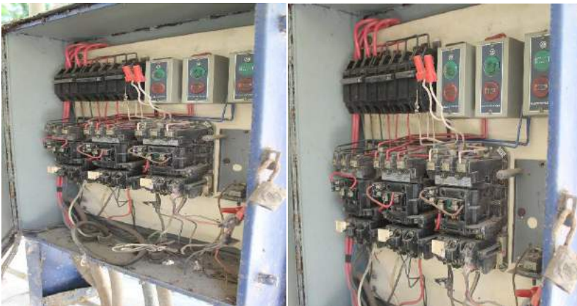
Imagen 50. Estado actual de tableros de planta de tratamiento de aguas residuales
