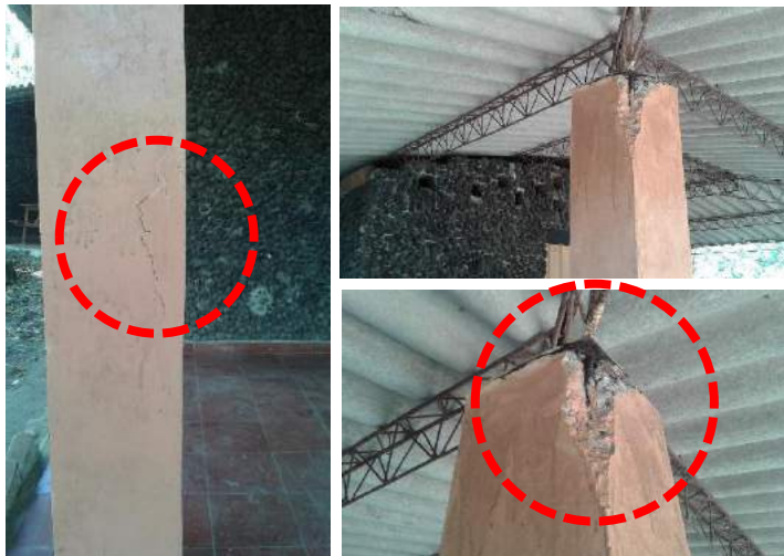
Imagen 33. Daños en el concreto
