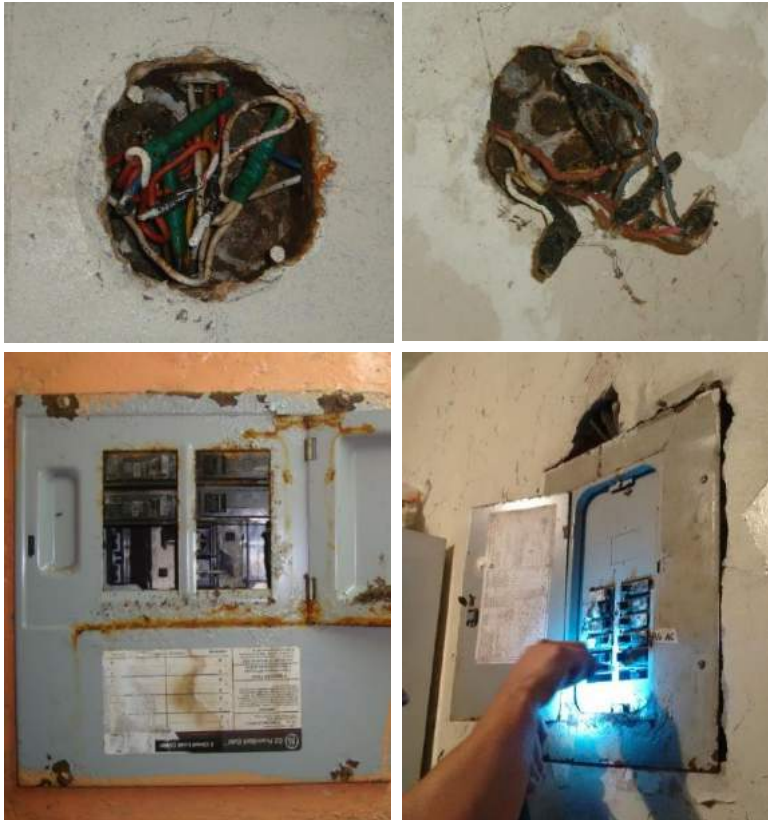
Imagen 44. Efectos de la corrosión en cajas de registro y tableros eléctricos
