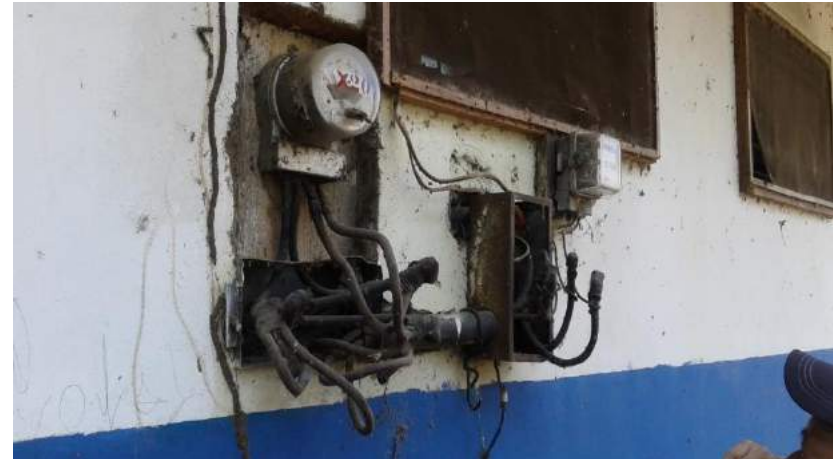
Imagen 48: Estado actual de acometida y medidor en el sector del cuartelillo
