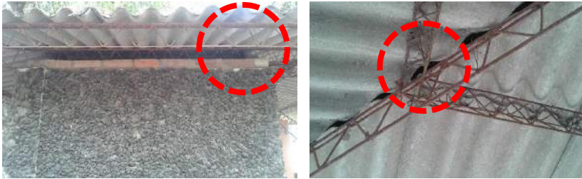
Imagen 32. Alto grado de corrosión en el sistema estructural de techo
