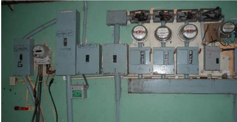
Imagen 46. Área de contadores y tableros eléctricos.
