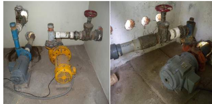
Imagen 51. Sistema de bombeo para abastecimiento de agua.
