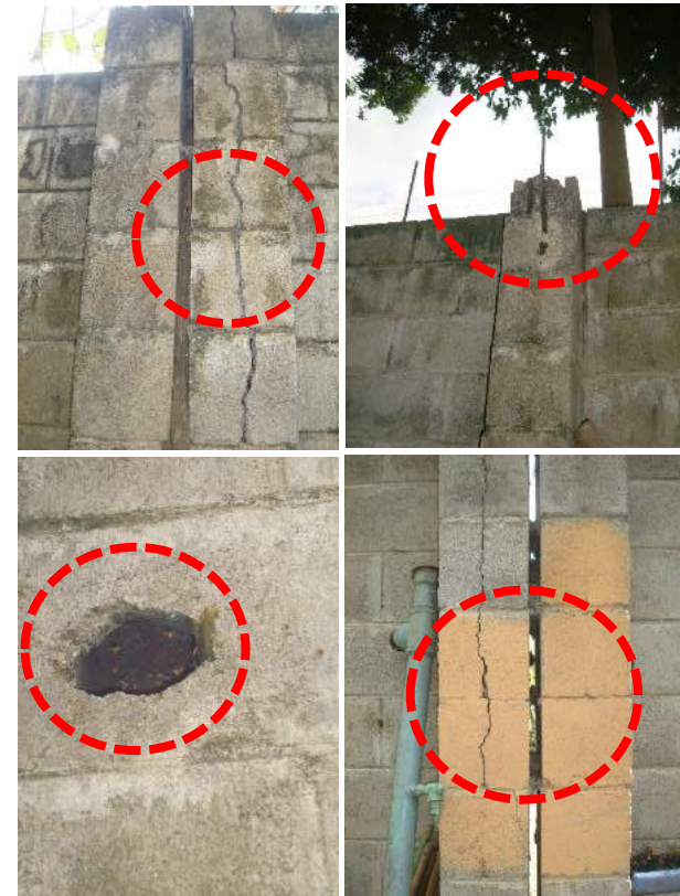
Imagen 29. Daños estructurales en contrafuertes
