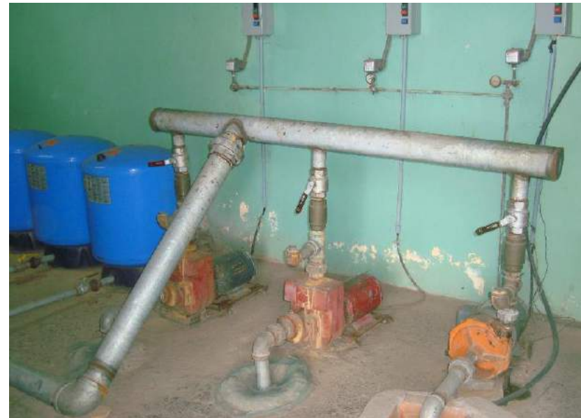
Imagen 45. Cuarto de bombas
