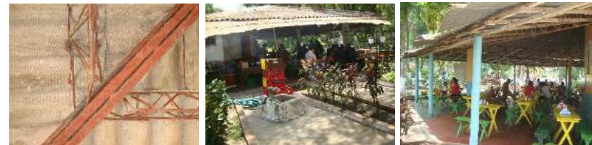
Imagen 34. Corrosión y deterioro del sistema estructural de techo
