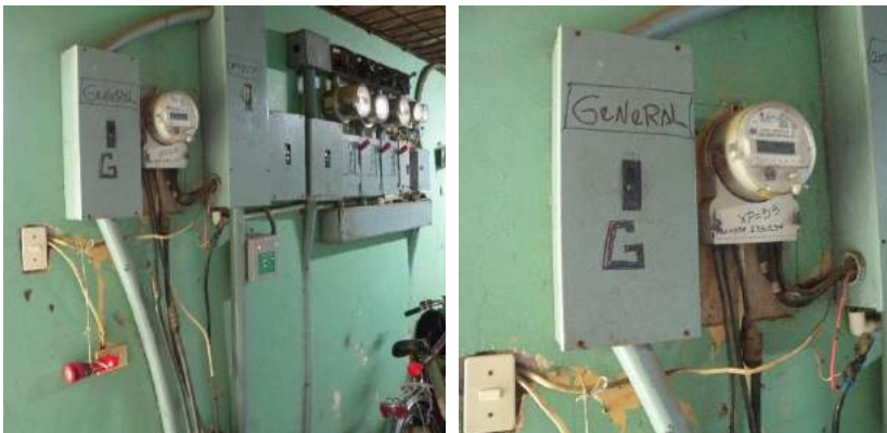
Imagen 47. Estado actual de instalaciones en cuarto de bombas
