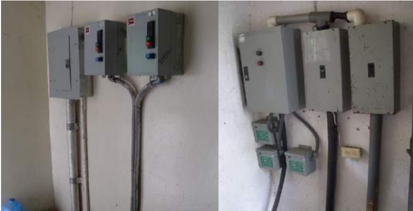
Imagen 52. Panel de control del sistema de bombeo
