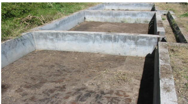
Figura 2.24 Lecho de Secado de Lodos
