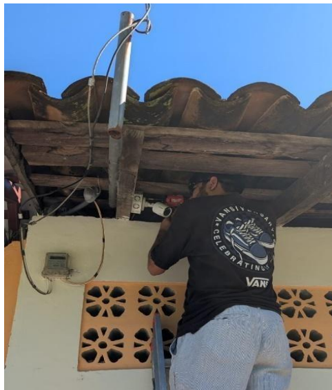
Figura 19 instalación de cámaras de video vigilancia
