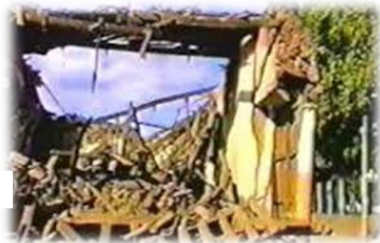
Fotografía 15: Casa destruida por terremoto de 2001.
