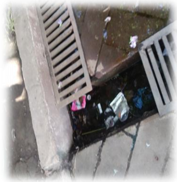
Fotografía 77: Canaletas en mal estado.
