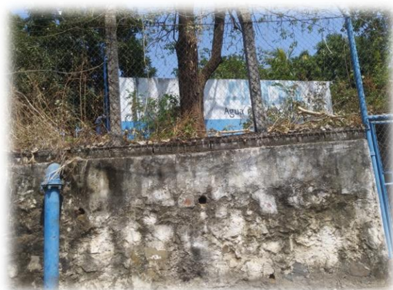
Fotografía 62: Bomba y tanque de ANDA.
