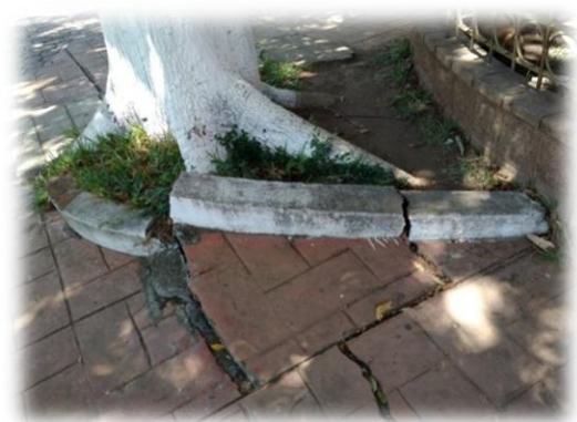
Fotografía 32: Acera deteriorada por árboles.
