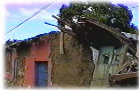
Fotografía 14: Casa destruida por terremoto de 2001.
