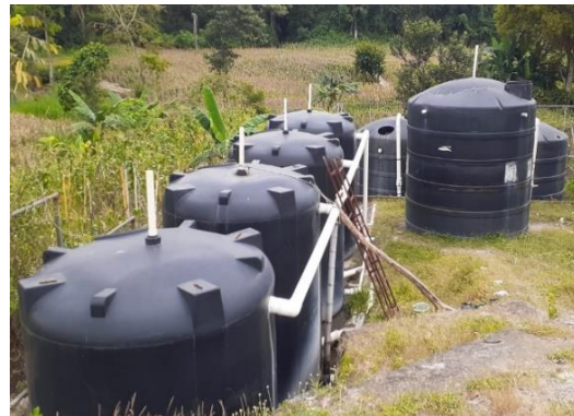
Figura 23. Planta de tratamiento de aguas residuales de San José Guayabal.
