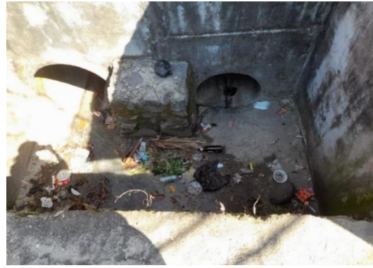
Figura 25. Desechos sólidos en tubería de drenaje en San José Guayabal.
