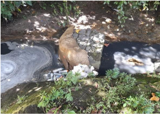
Figura 24. Drenaje obstruido con desechos sólidos en San José Guayabal.
