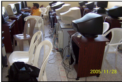
Foto 5.34 Ubicación del cableado
