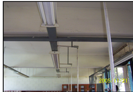
Foto 5.16 Vista del cableado aéreo
