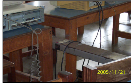
Foto 5.23 Cableado eléctrico de mesas de trabajo
