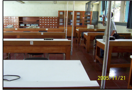
Foto 5.14 Cableado de las mesas de trabajo
