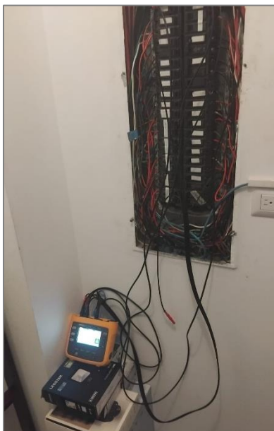
Figura 19: Conexión de FLUKE 1746 por técnicos de la empresa distribuidora.
