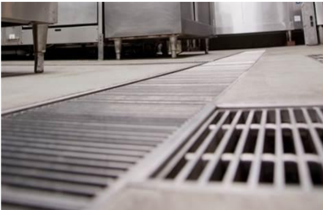
Sistemas de drenaje en plantas de alimentos
