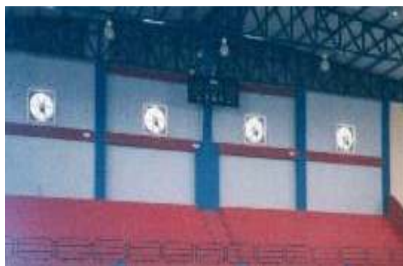
Sistema de ventilación en Gimnasio
